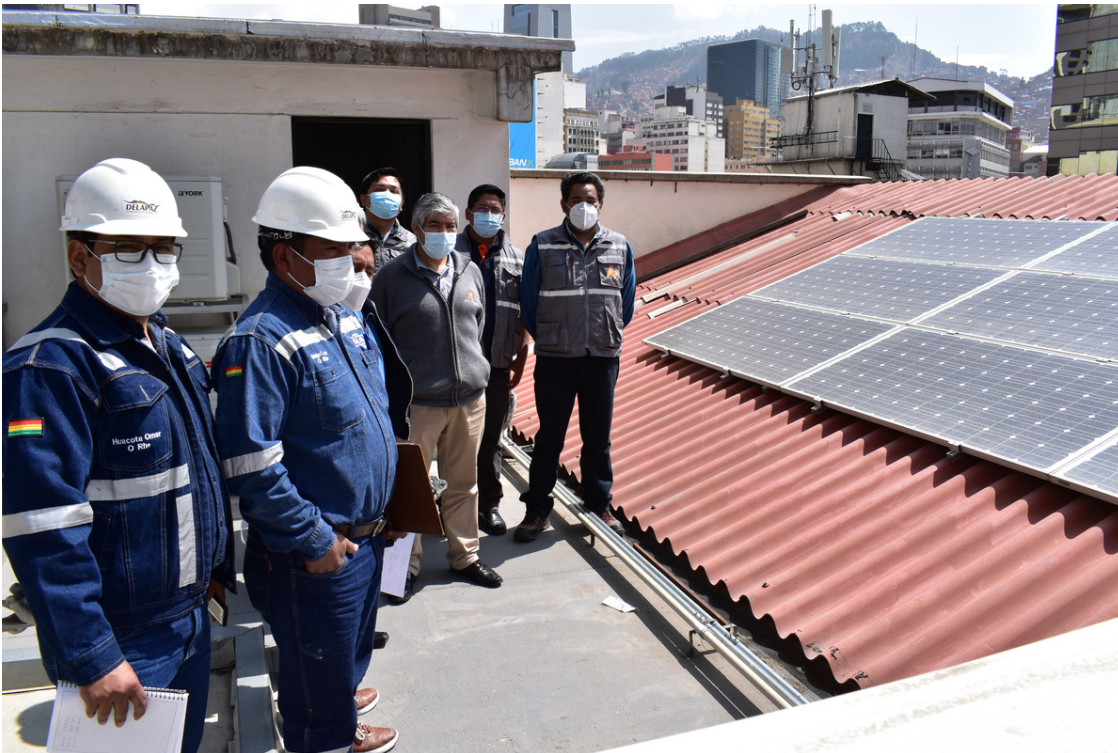
Inspección a Sistema Fotovoltaico de la AETN, La Paz.
